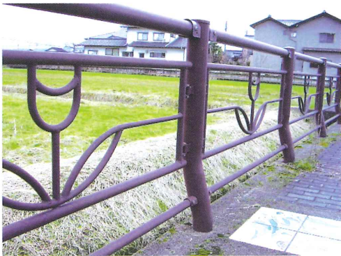
ガードレール
